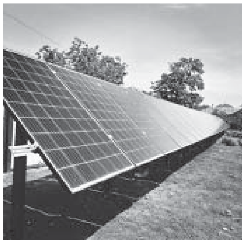
Figura 2 Panouri fotovoltaice amplasate la sol
